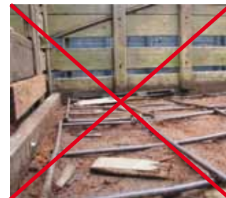
GRADES TORCIDAS E QUEBRADAS
